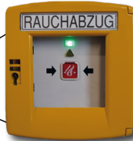
Abb. 19 Rauch- und Wärmeabzugsanlage (RWA)
